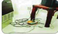
استخدام التوصيلات الكهربائية بشكل ضغطاً على الكهرباء، وخطورة على الإنسان
