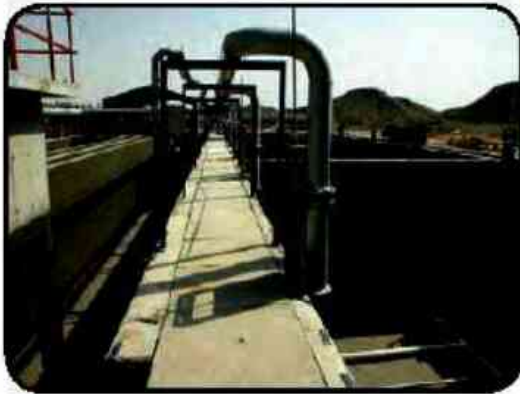
شكل (٢١) محطة الصرف الصحي بالرياض
