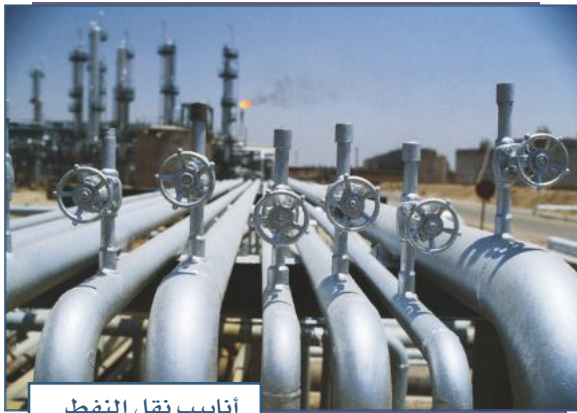
أنابيب نقل النفط
